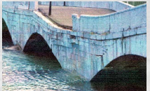
Zubiaren egoera Estado en que quedó el puente
